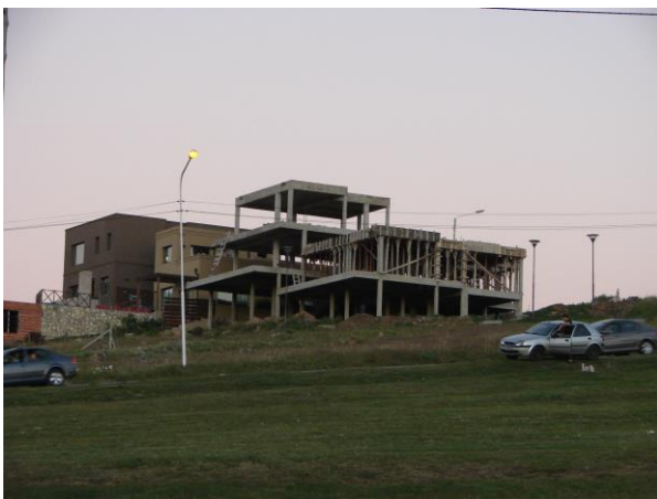
Figura 2: Vivienda Terminada y rodeada de otra recién construida y estructura de loza nueva al pie de Sierra de Tandil
