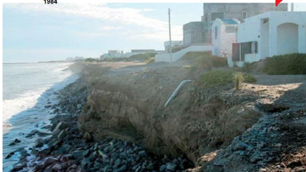
corte de Avenida Costanera de Costa Bonita por erosión costera
